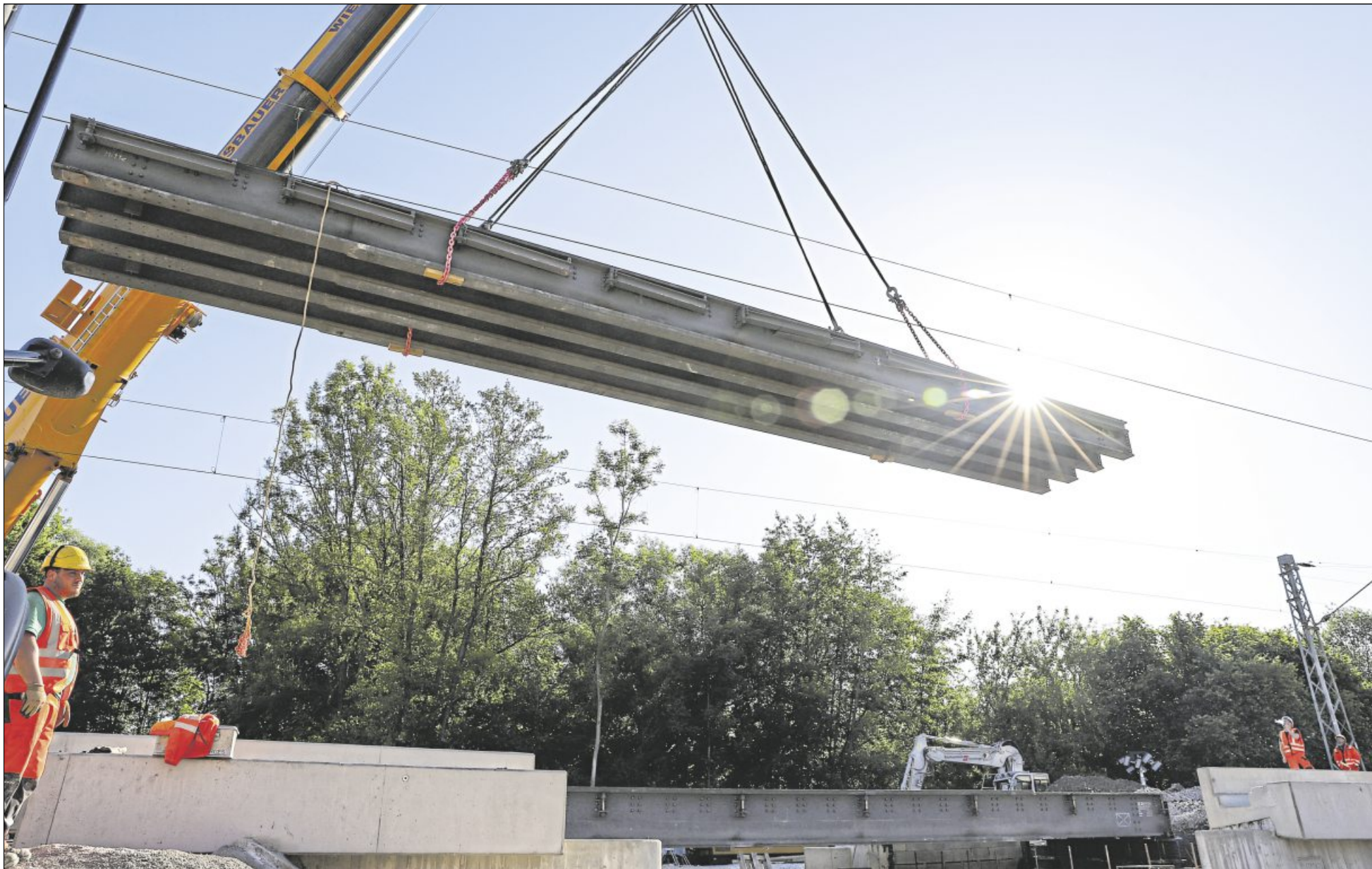
Ein halbes Jahr lang hat diese Behelfsbrücke den Zugverkehr auf der Remsbahnschiene getragen. Am Montag wurde die neue Brücke eingesetzt.
